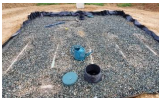
Filtre à sable
